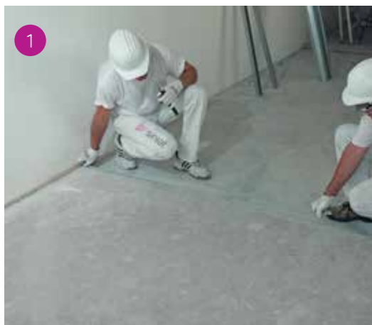
Tracciamento con filo tracciante per la realizzazione di una parete di tipo S.
