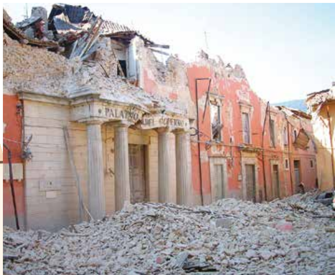
Danni causati da un terremoto
