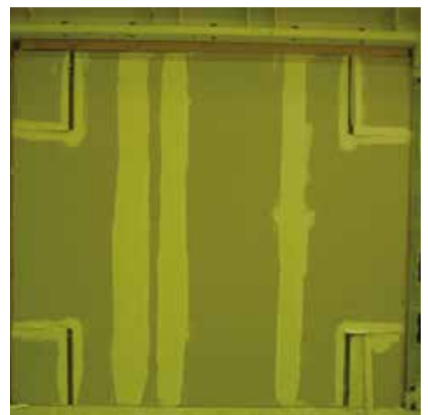
Test nel piano - Danneggiamento localizzato e controllato degli angoli al termine della prova
