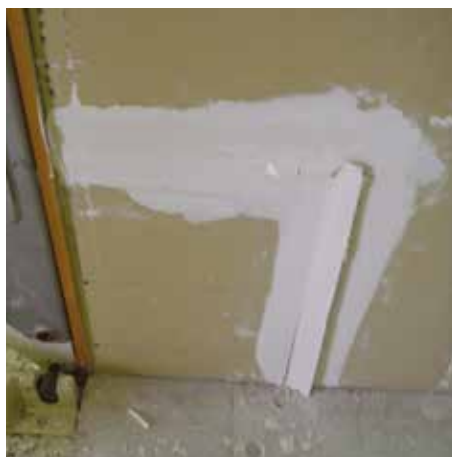
Inizio del danneggiamento del rivestimento in corrispondenza del fusibile
